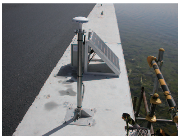
図1 変位計測用 GPS センサー（ソーラー電源・ワイヤレス通信）
