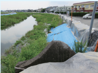
益城町木山地区の液状化による流動現象
