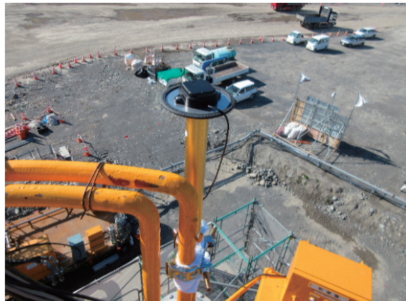
図3 アンテナの設置状況
