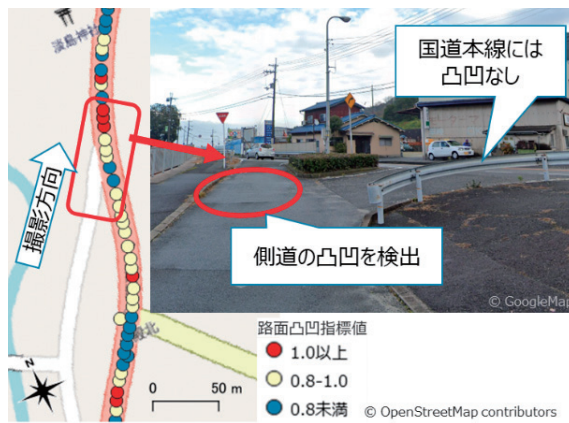
図5 側道の路面の凸凹検出の事例
