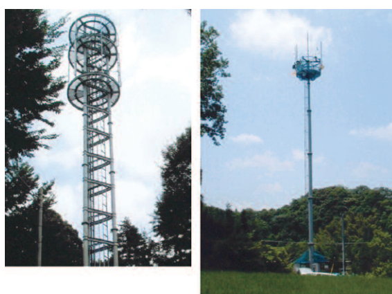
図28 次世代型モバイル通信のためのアンテナ設置 【提供：(株) 協和エクシオ】
