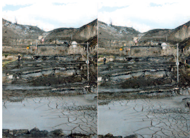
写真3 潜在ドームの隆起により階段状に変形した国道230号線（2000年11月2日千葉撮影、位置は図3に示す。立体視可能）
